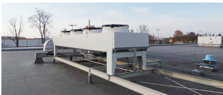
Rys. 3. Usytuowanie na dachu Gas Cooler'a
