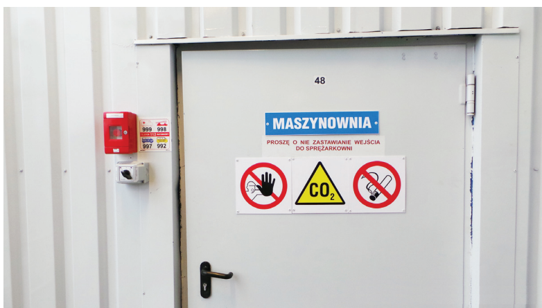
Rys. 4. Oznakowanie maszynowni technicznej
