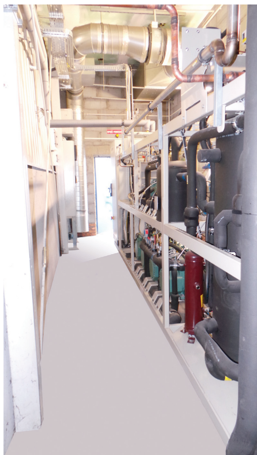
Rys. 2. Maszynownia Carrefour Sochaczew
